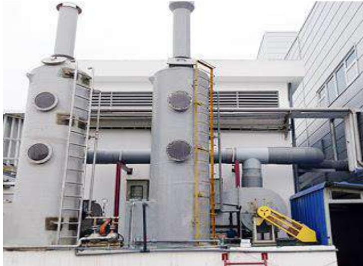
(Hệ thống xử lý mùi điển hình)
